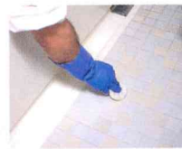
タイルのもらいサビ・スケール汚れ
