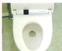
トイレの排水の詰まりや悪臭
