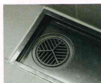
グレーチングの石鹸カス・スケール汚れ
